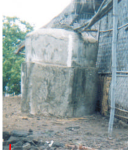
Bak penampung air hujan dari atap rumah, Alor, NTT. (Foto J. Ruijter).
